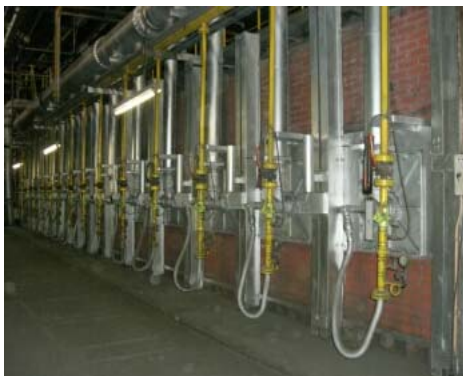
トンネル式焼成炉
