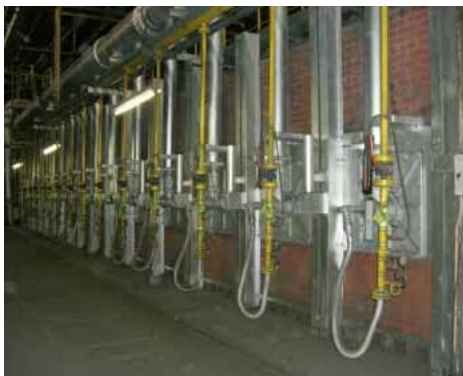
トンネル式焼成炉
