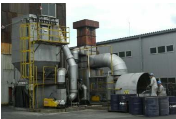
燃焼式脱臭装置の設置例(八幡)
