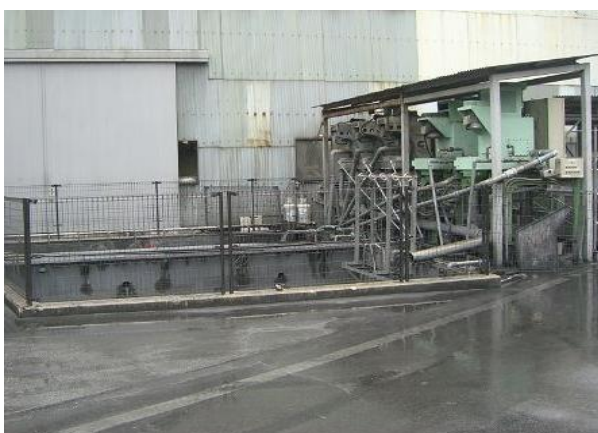
加工汚泥処理装置(処理量：約40m 3 /日) 九州耐火煉瓦(株)
