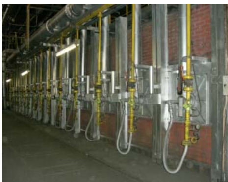
トンネル式焼成炉
