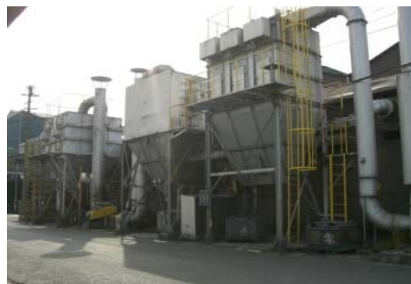
大型集塵機の設置例(八幡)
