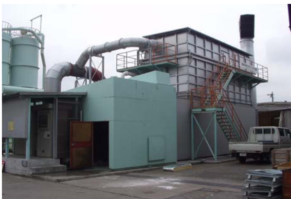
RTO装置によりタール臭を完全に排除 (株)SNリファインメント東海
