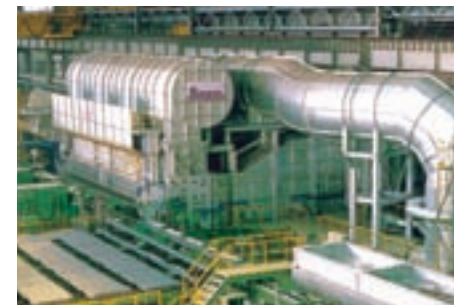
プッシャー式ピレット連続式圧延加熱炉
