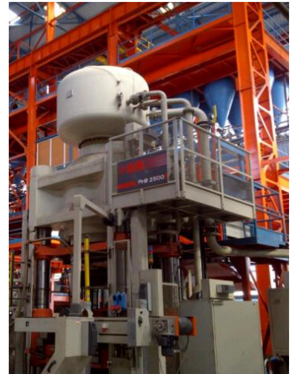
マッド工場秤量設備
