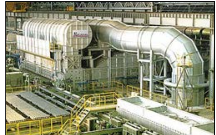
プッシャー式加熱炉外観
