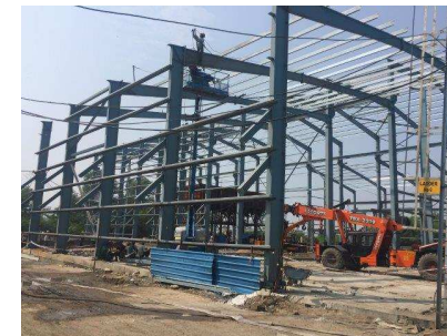
マッド工場新建屋建設中。現工場はフル稼動状態であり、更なる需要増に対応。
