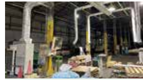
熱中症対策 作業エリアにエアコン設置 作業環境の整備にも力をいれており、働きやすい職場を実現しています。
