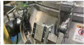
ミキサーの開口部にはリミッタースイッチを設け、稼働中はアプローチできない設定となっています。
