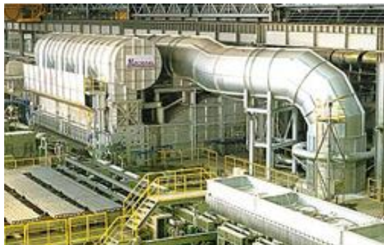
施工例)プッシャー式ヒレット連続式圧延加熱炉
