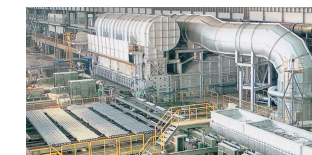
プッシャー式ピロット連続加熱炉
