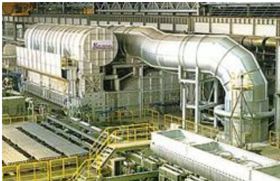
施工例)プッシャー式ビレット連続式圧延加熱炉
