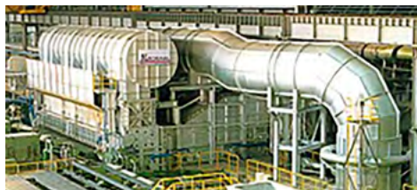
(施工例) プッシャー式ピレット連続式圧延加熱炉
