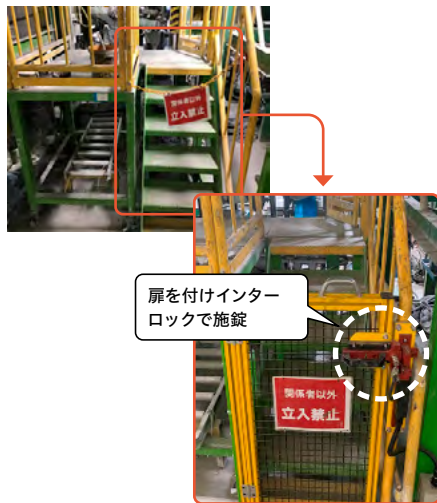
設備稼働中の立入を防ぐインターロック機構
